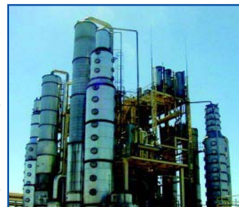
Vista dos aparelhos de destilação da Usina Buriti
