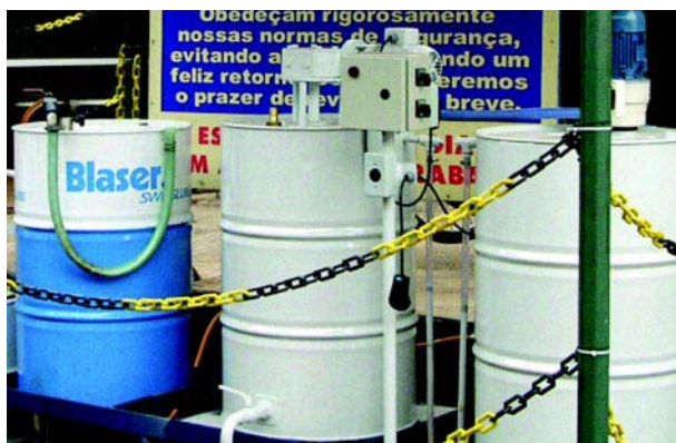
O sistema em funcionamento na unidade de manufatura da Smar
