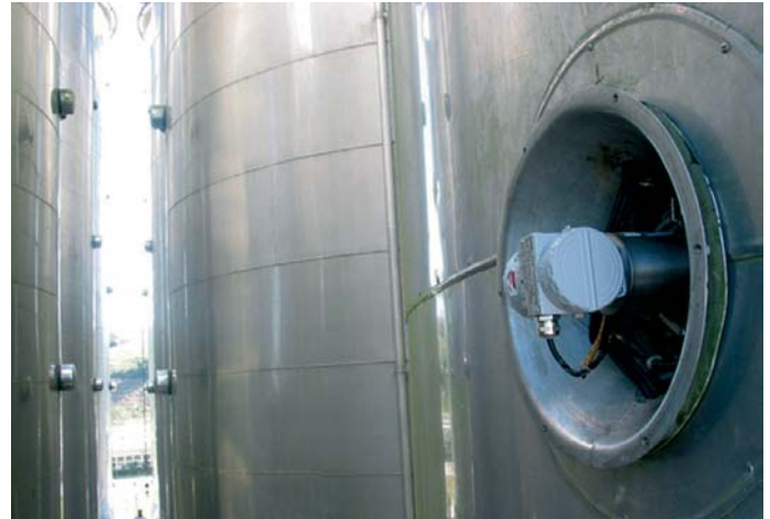
Figura 4: DT302S - Instalado no Tanque de Fermentação
