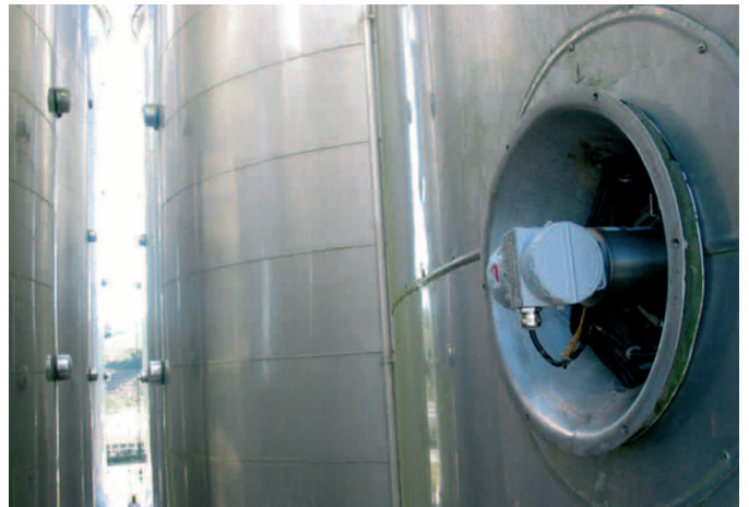
Figura 4: DT302S instalado en el Tanque de Fermentación
