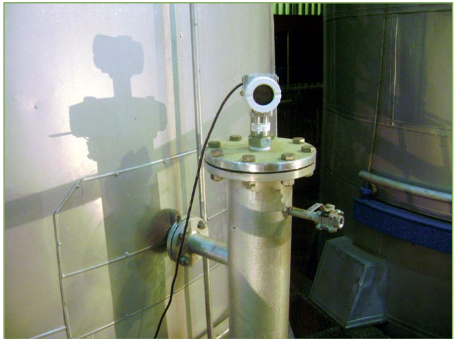
F5. Transmissor instalado no vaso.
