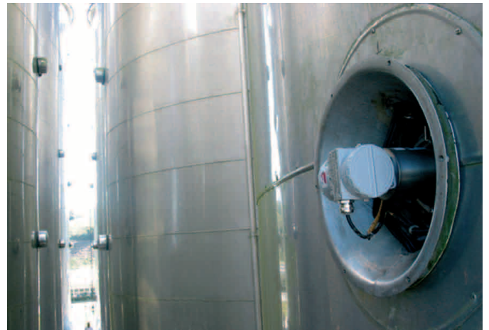
Figura 4: DT302S instalado en el Tanque de Fermentación
