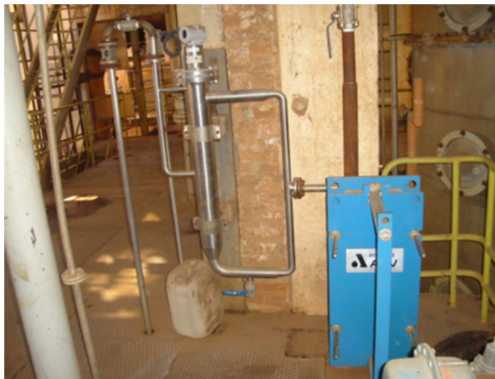
Instalação do DT301 na Saída da Coluna de Destilação
