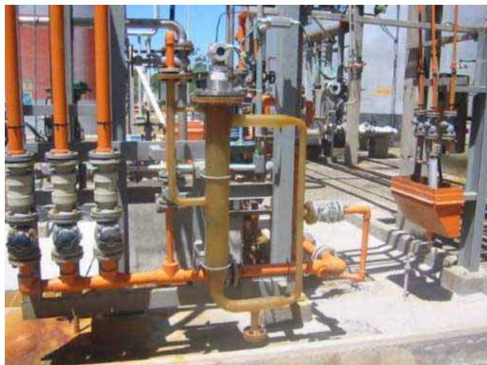
Figura 2.21 – Instalación Midiendo Acido Clorhídrico
