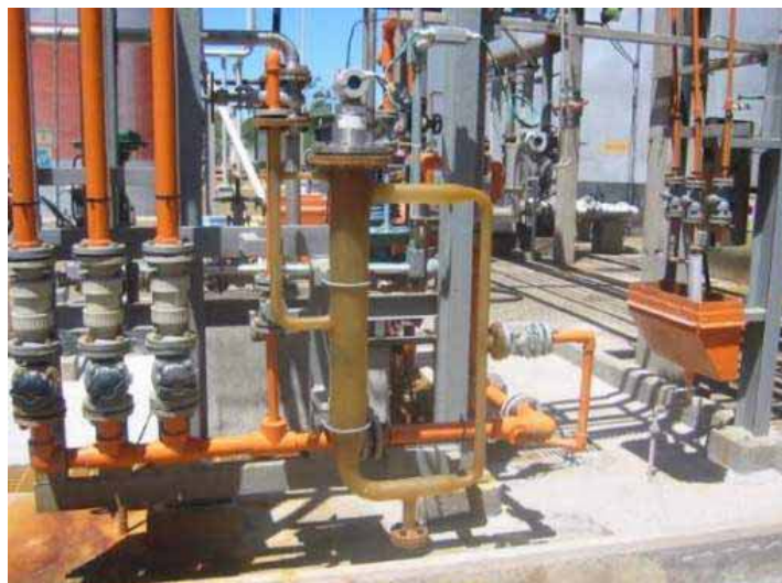
Figura 2.21 – Instalación Midiendo Acido Clorhídrico
