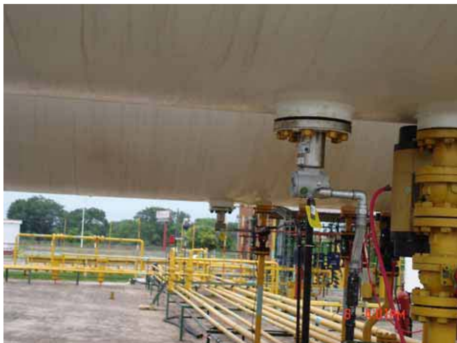
Figura 2.29 – Medición de GLP en Tanque
