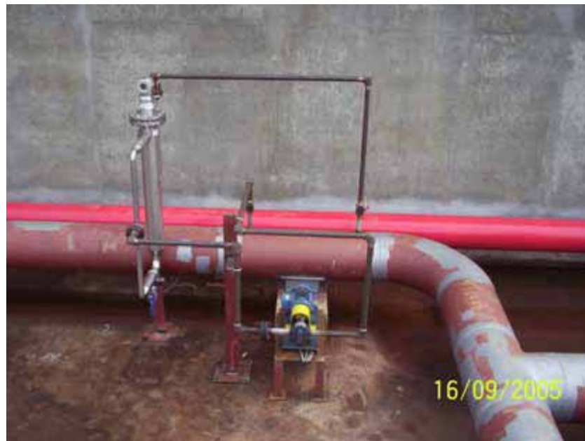
Figura 2.27 – Recirculación con Bomba
