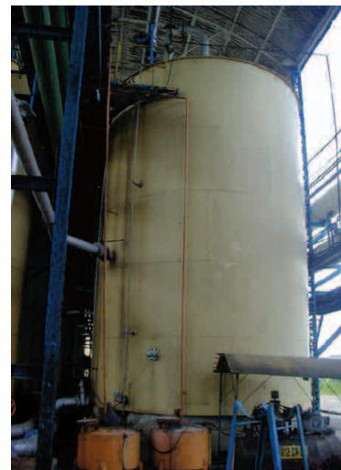
Tanque de Fermentación Usina Caeté - Matriz
