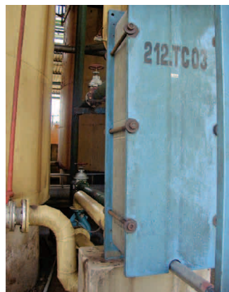
Ilustración fotográfica del Conjunto de Enfriadores-Bomba-Inversor
