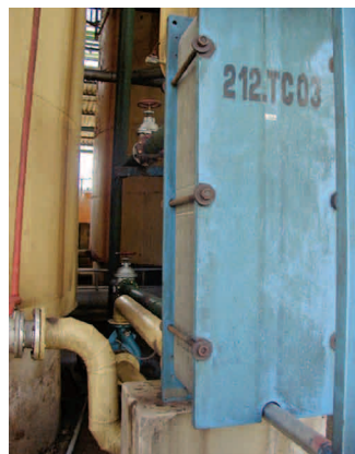
Ilustración fotográfica del Conjunto de Enfriadores-Bomba-Inversor
