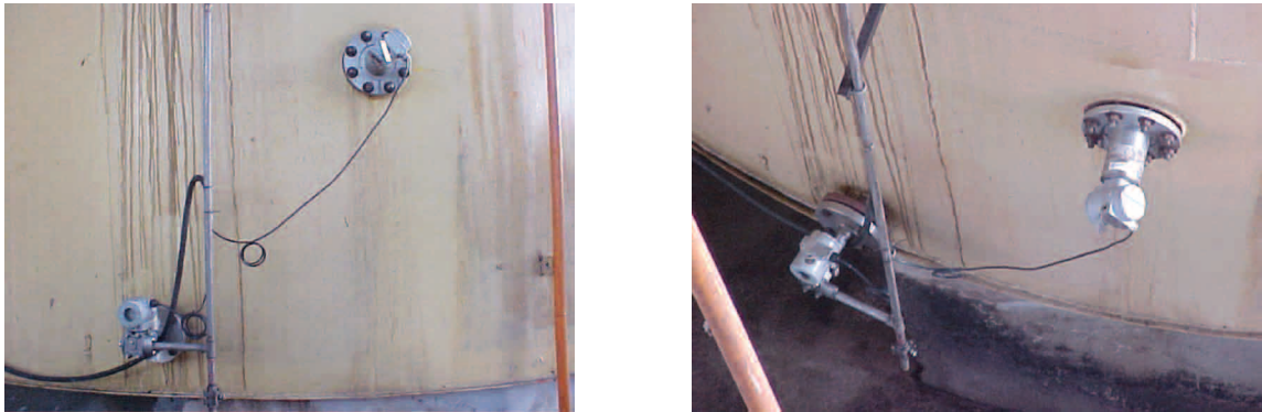
Ilustración fotográfica de instalaciones de transmisores de nivel LD301L y de densidad/concentración DT301
