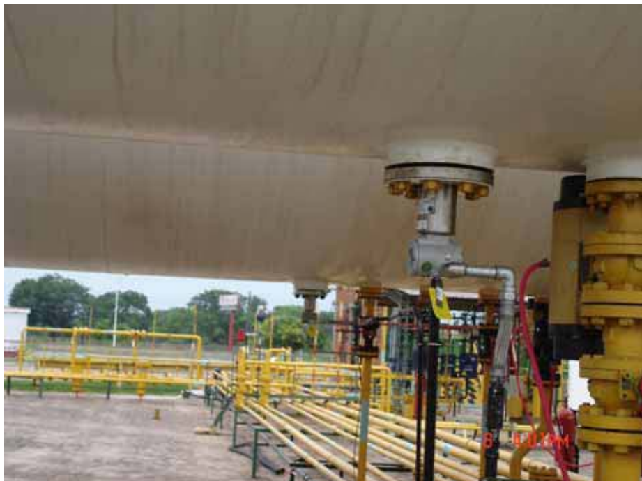
Figura 2.29 – Medición de GLP en Tanque
